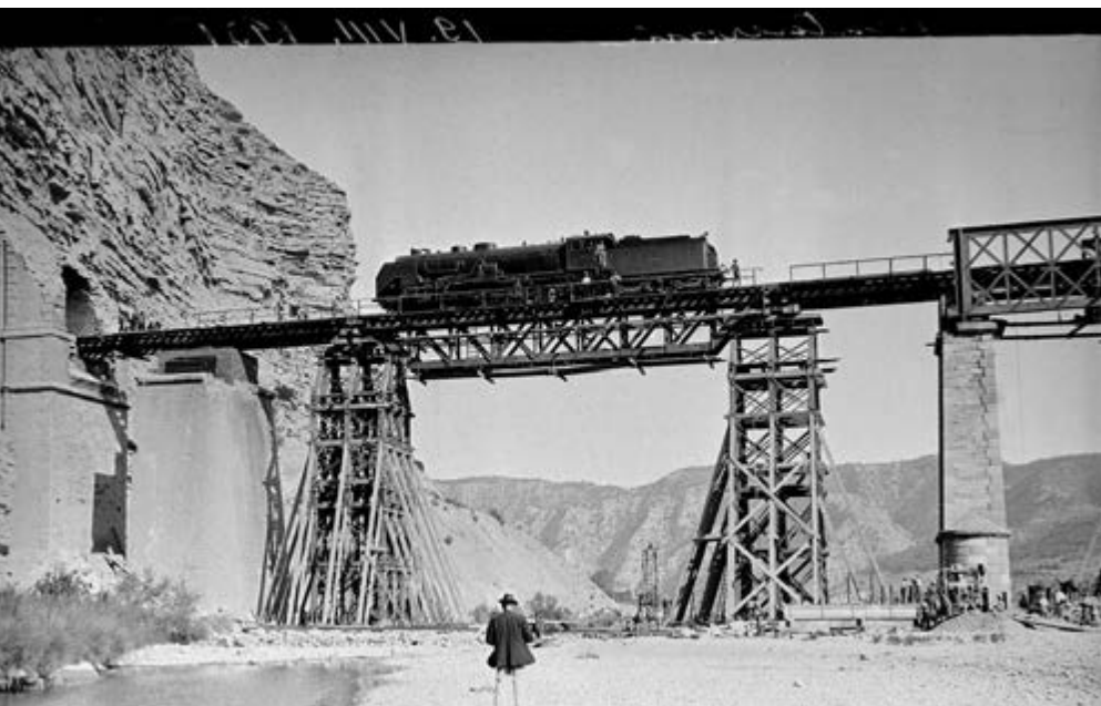
Prueba de carga del tramo de vía provisional instalado sobre dos castilletes de traviesas, para restablecer el servicio de la línea tras el accidente. 19 de agosto de 1931.
